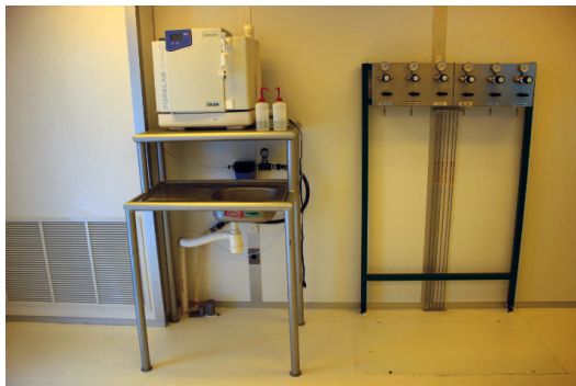
FIGURA 1. Deionizador de agua y líneas de gases.
