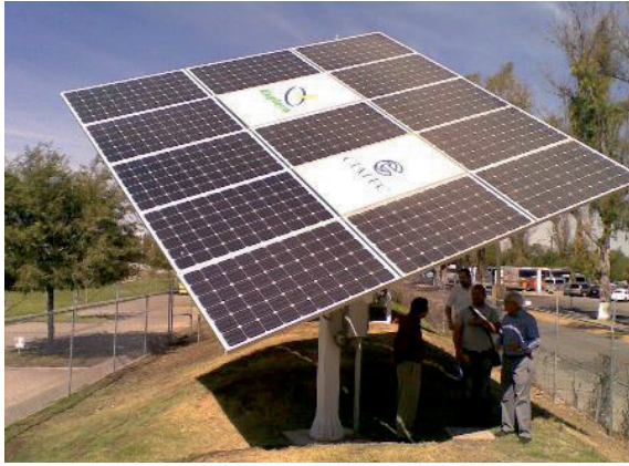
FIGURA 4. Panel solar ubicado en Explora, Centro de Ciencias en León, Gto., con seguidor solar patentado por CIATEC.
