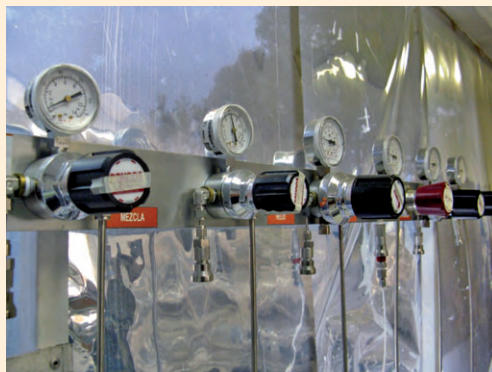
IMAGEN 5. Detalle de los puntos de uso de gases, instalado en el LMN del CCADET.
